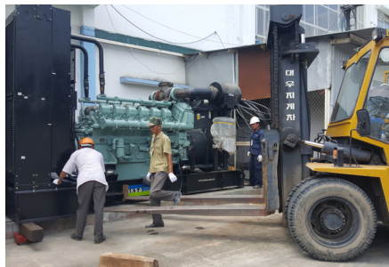
DỰ ÁN NHÀ MÁY PHÁT ĐIỆN NHÀ MÁY SỮA TH TRUEMILK HÀ NỘI
